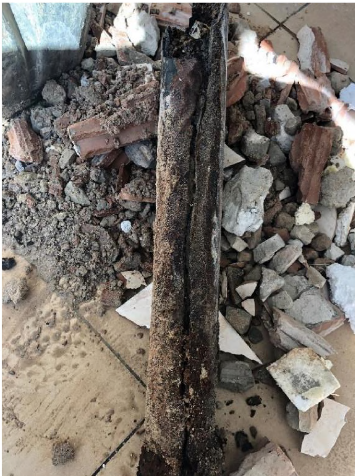
ZŠ Podzáhradná – havarijný stav dažďových zvodov
